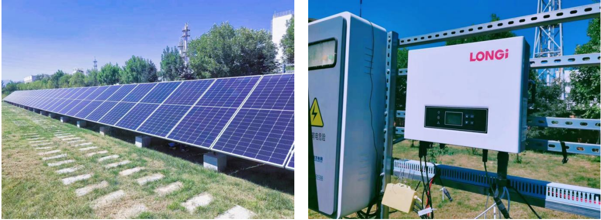
图6 20kW光伏发电站
